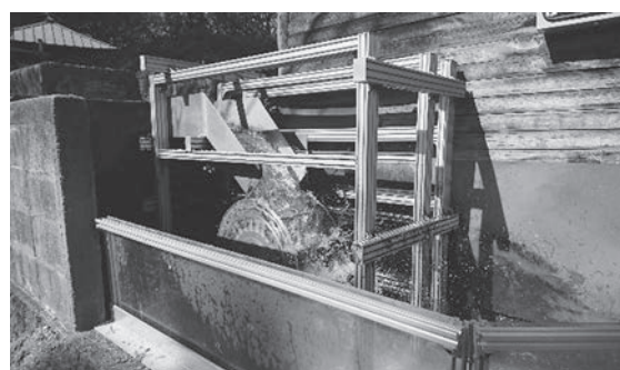
写真1 マイクロ小水力発電設備 (桐生市黒保根町)
